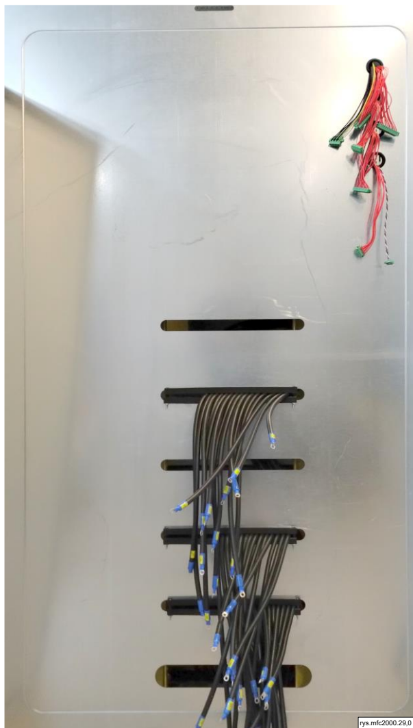
Rys. 12. Szafa modułów mocy - wyprowadzenia przewodów
