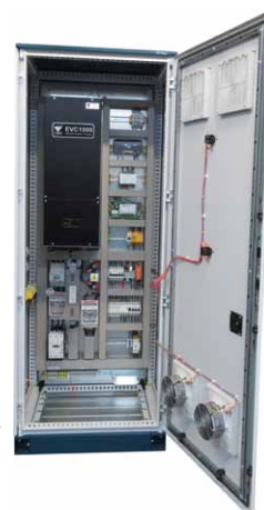
Rys. 1. Dwukierunkowa ładowarka EVC1000 z tranzystorami mocy z węgla krzemu (SiC) wraz z niezbędnym osprzętem, zabudowana w szafie sterowniczej
